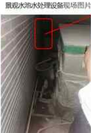
现场缝隙较大
